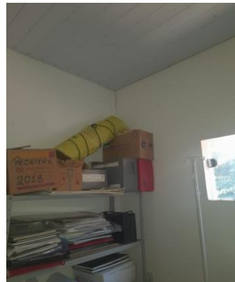
Parede com trinca
