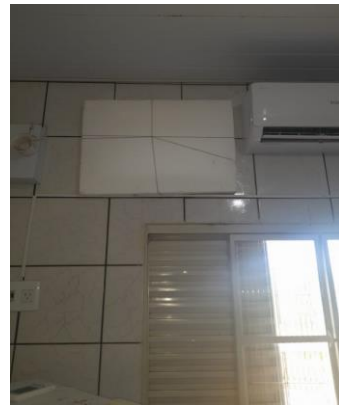
Buraco na parede
