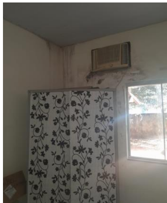
Parede com infiltração de água
