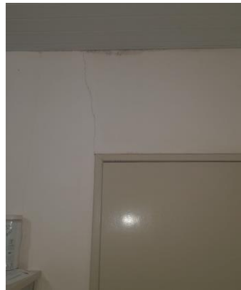
Parede com trinca
