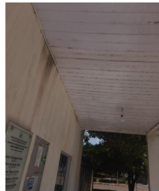
Infiltração de água na parede
