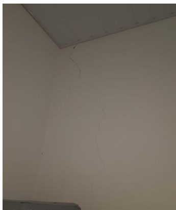
Parede com trinca
