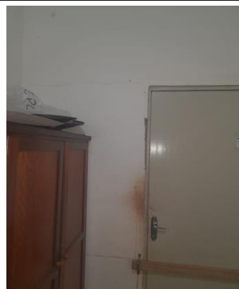
Parede com trinca e manchada
