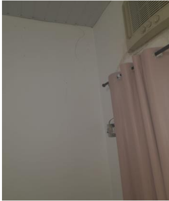
Parede com trinca
