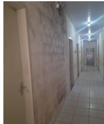
Parede com mofo
