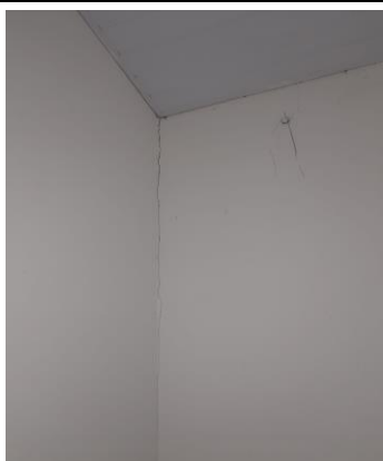
Parede com trinca
