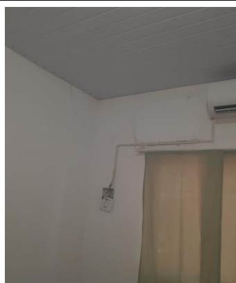
Parede mal acabada
