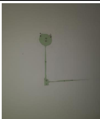
Parede com furos
