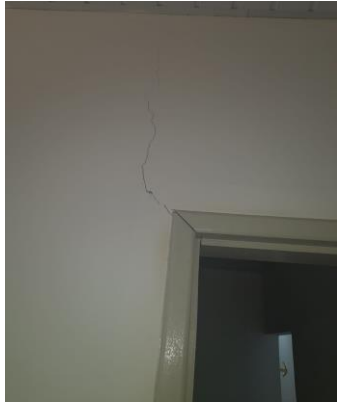
Parede com trinca
