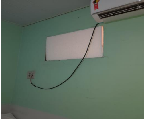
BURACO NA PAREDE
