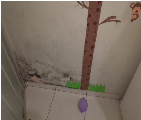
MOFO NAS PAREDES
