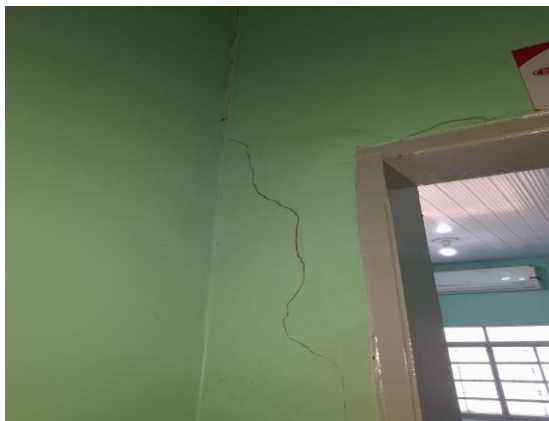
TRINCA NA PAREDE
