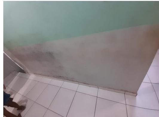
MOFO NAS PAREDES
