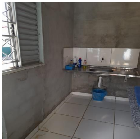
PAREDES SEM EMASSAMENTO E PINTURA
