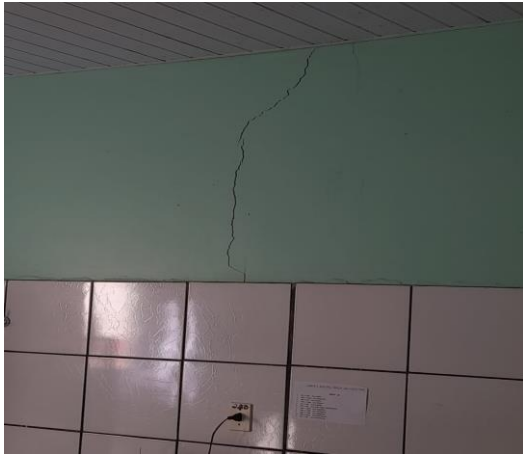
FISSURAS NA PAREDE
