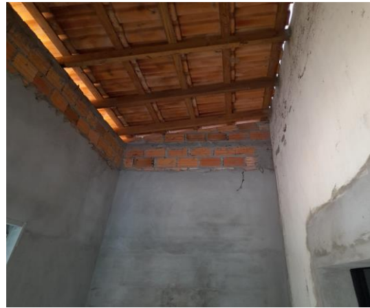
PAREDES SEM EMASSAMENTO E PINTURA
